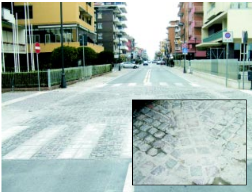
L'arredo urbano di viale Pinzon è già duramente provato. Di recente si è reso necessario bloccare il porfido con cemento a presa rapida: quanto durerà?
