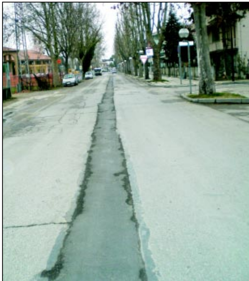
La "trincea" di viale Ennio a Bordonchio: quasi sempre chi esegue lavori di scavo sulle strade comunali, non si preoccupa di asfaltare a lavori ultimati.
