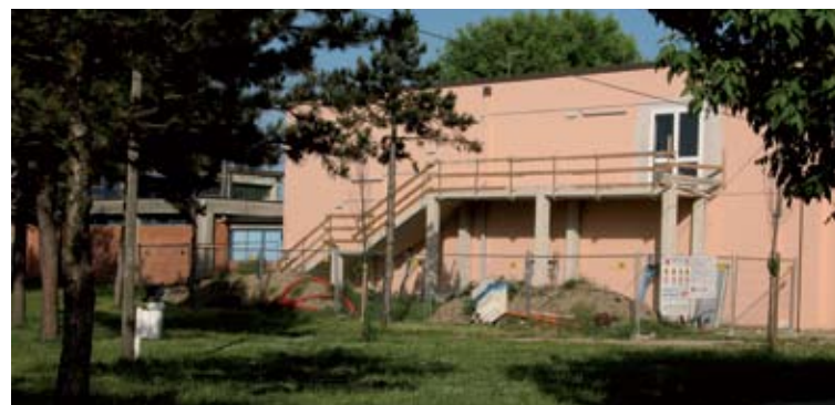
La scala antincendio del Ferrarin fotografata il 23 maggio. Uno dei tanti lavori in ritardo a causa della disorganizzazione dell'amministrazione. Il Nuovo trattò questo tema nel 2005, quando allora si attendeva la darsena. Avvertimmo dell'aleatorietà del progetto e solo un paio di anni fa fummo ascoltati. L'assessore Zavatta, oggi candidato per la Bondoni, prima promise in Consiglio d'Istituto con assoluta certezza che sarebbe stata pronta entro l'estate scorsa. Poi al Nuovo parlò di ottobre. Infine disse "non oltre febbraio". Queste le parole della (cattiva) politica. I fatti sono che i bambini hanno frequentato e frequentano tutt'ora una scuola fuori norma. I tempi della politica non sono i tempi della sicurezza. Ma c'è una sorpresa. Al momento di andare in stampa, vediamo che alcuni operai stanno lavorando con lena. Volete scommettere che la scala sarà pronta per la fine delle lezioni, ovvero quando i bambini saranno a casa, dopo aver trascorso l'ennesimo anno senza sicurezza? Ovvero per il 6 giugno. Ma cosa accade il 6 giugno? Chi indovina?
